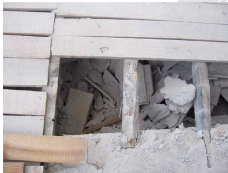
Fotografía de una de las grandes vigas del lado Este en el que se aprecia el ataque de pudrición motivado por los accesos de agua.
